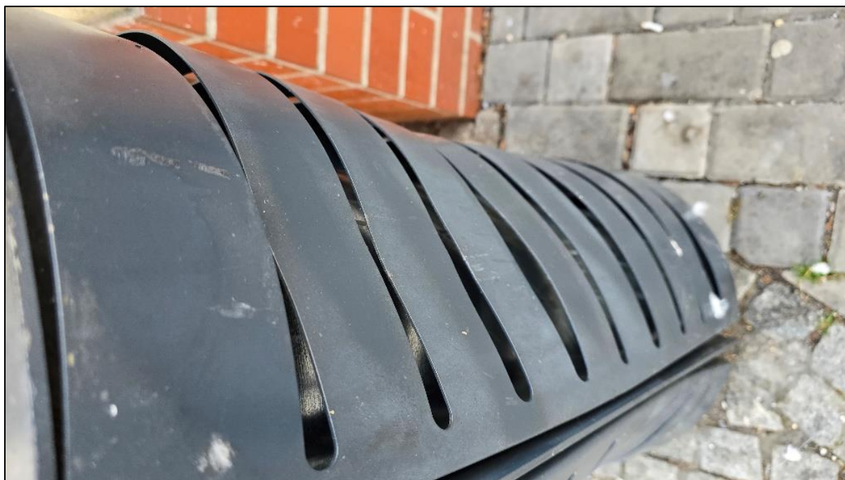
Obr. č.2: Mech. Poškozené lamely
